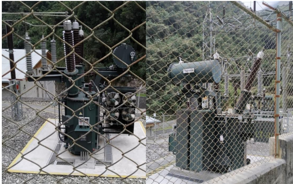
Figura 5.8 Transformador de Potencia de Planta Hidroeléctrica Cuticucho Fuente: Elaboración propia
