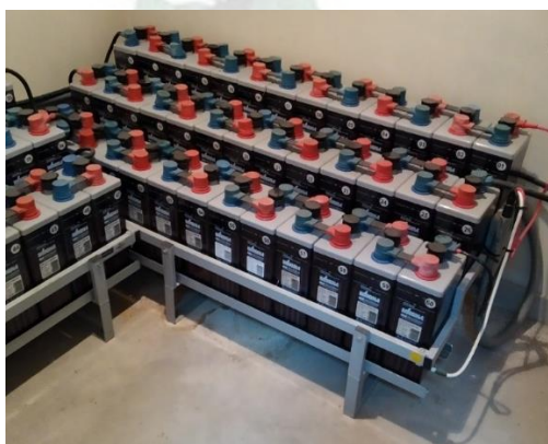
Figura 5.12 Banco de Baterías Planta Hidroeléctrica Cuticucho Fuente: Elaboración propia
