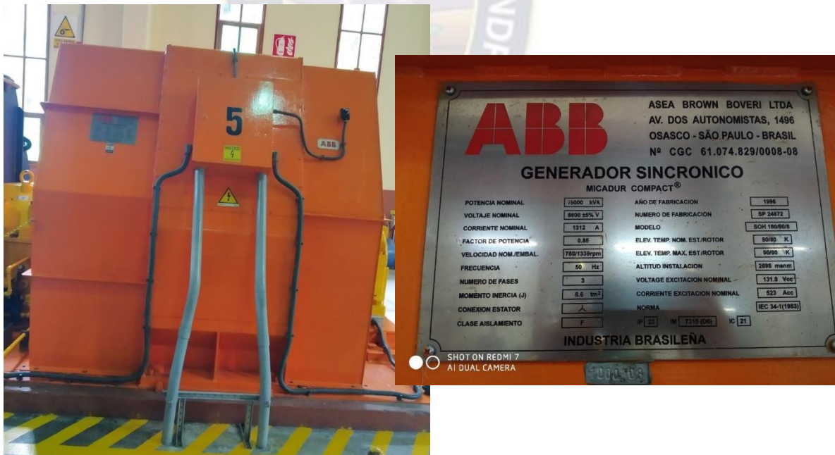
Figura 5.7 Generador de la Unidad 5 y Placa Característica Fuente: Elaboración propia
