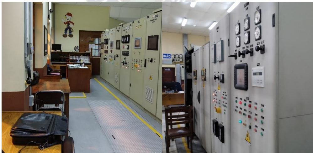
Figura 5.10 Sala de Control Planta Hidroeléctrica Cuticúcho
