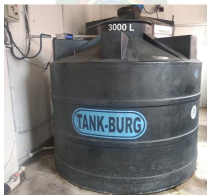
Figura 2.8 Tanque de almacenamiento de agua blanda
