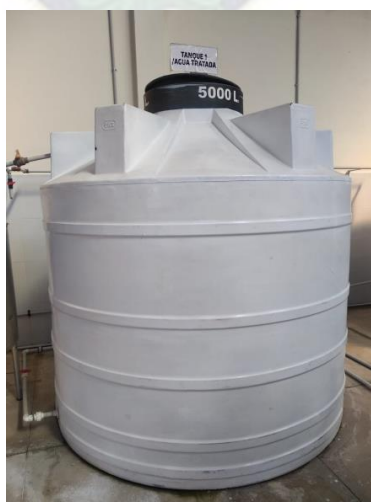
Figura 2.11 Tanque de almacenamiento de agua purificada
