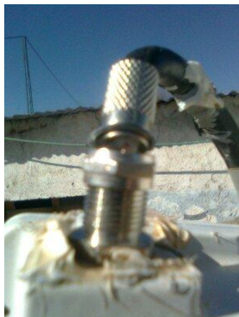
Fig. 59 Conector Coaxial en mal estado (Fuente: Material de Visión Mundial)
