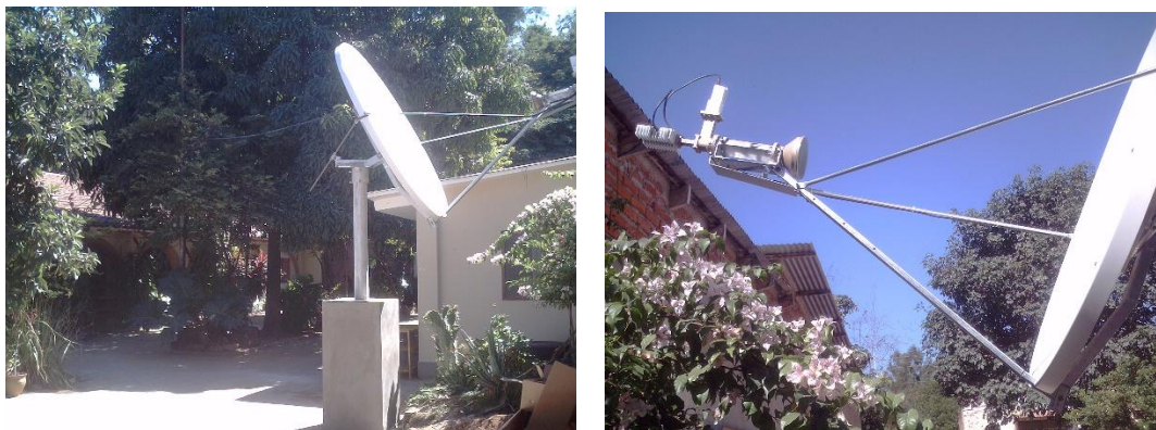
Fig. 45 Antena montada en estructura de concreto (Fuente: Vision Mundial, año 2009)
