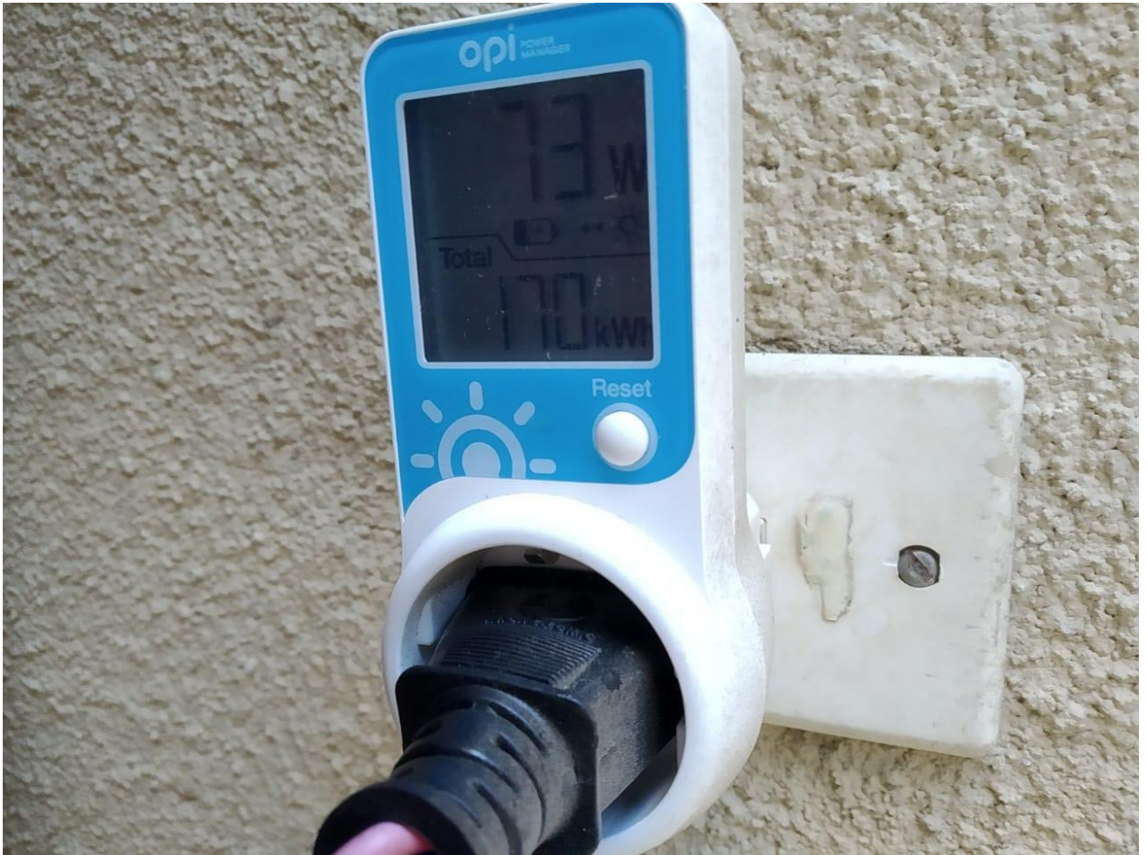
Fotografía 12 Medidor AC marcando la generación de Energía Solar
