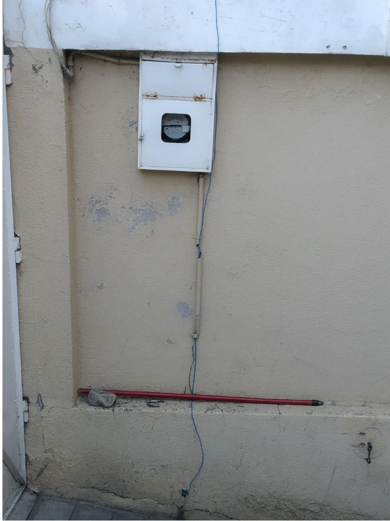
Fotografía 11 Varilla de Puesta a tierra en el domicilio
