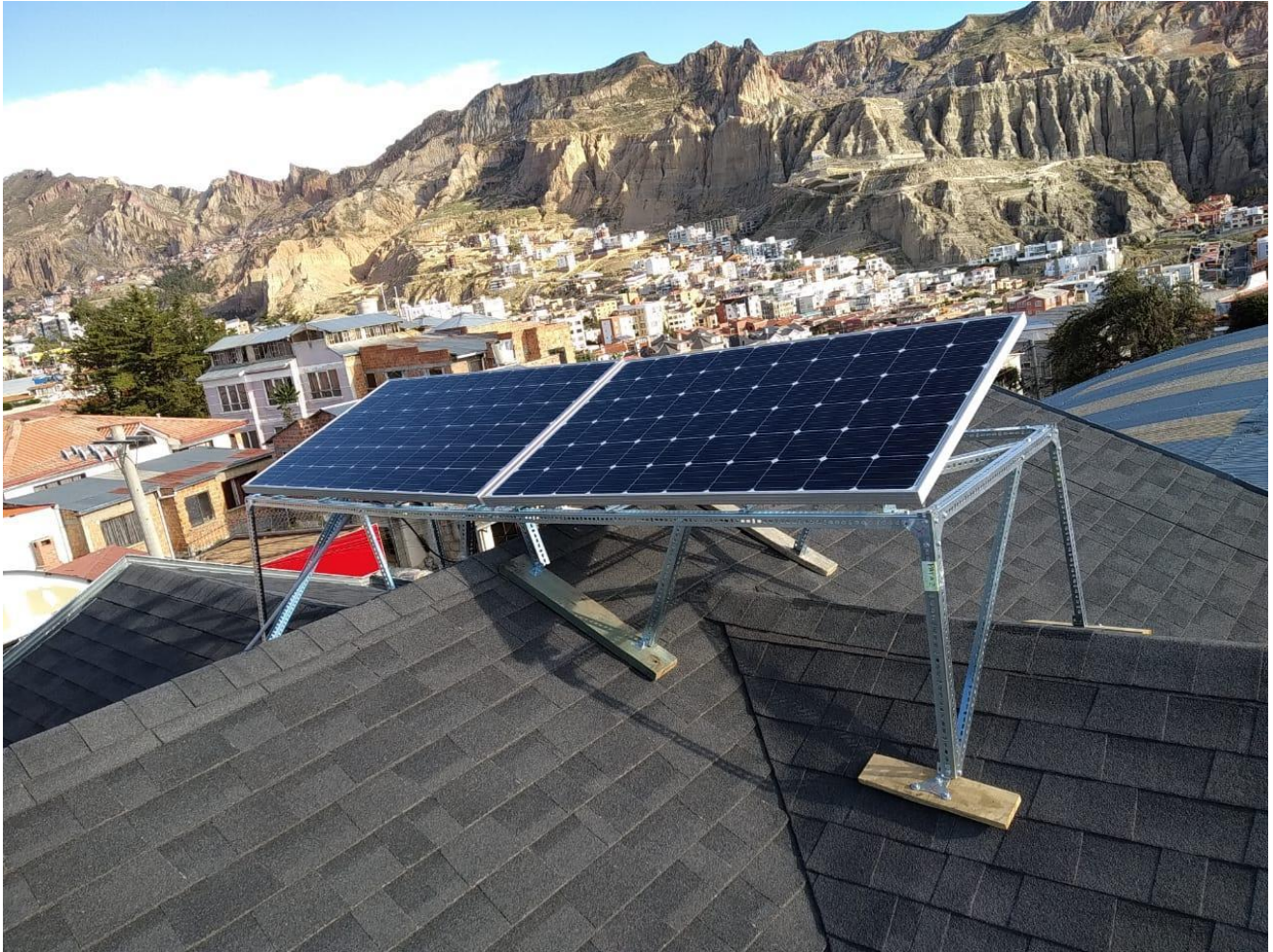
Fotografía 10 Montaje y conexiones finalizadas
