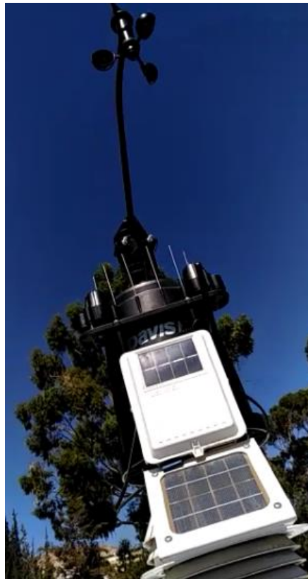
Fotografía 15 Data Logger, medición radiación solar.
