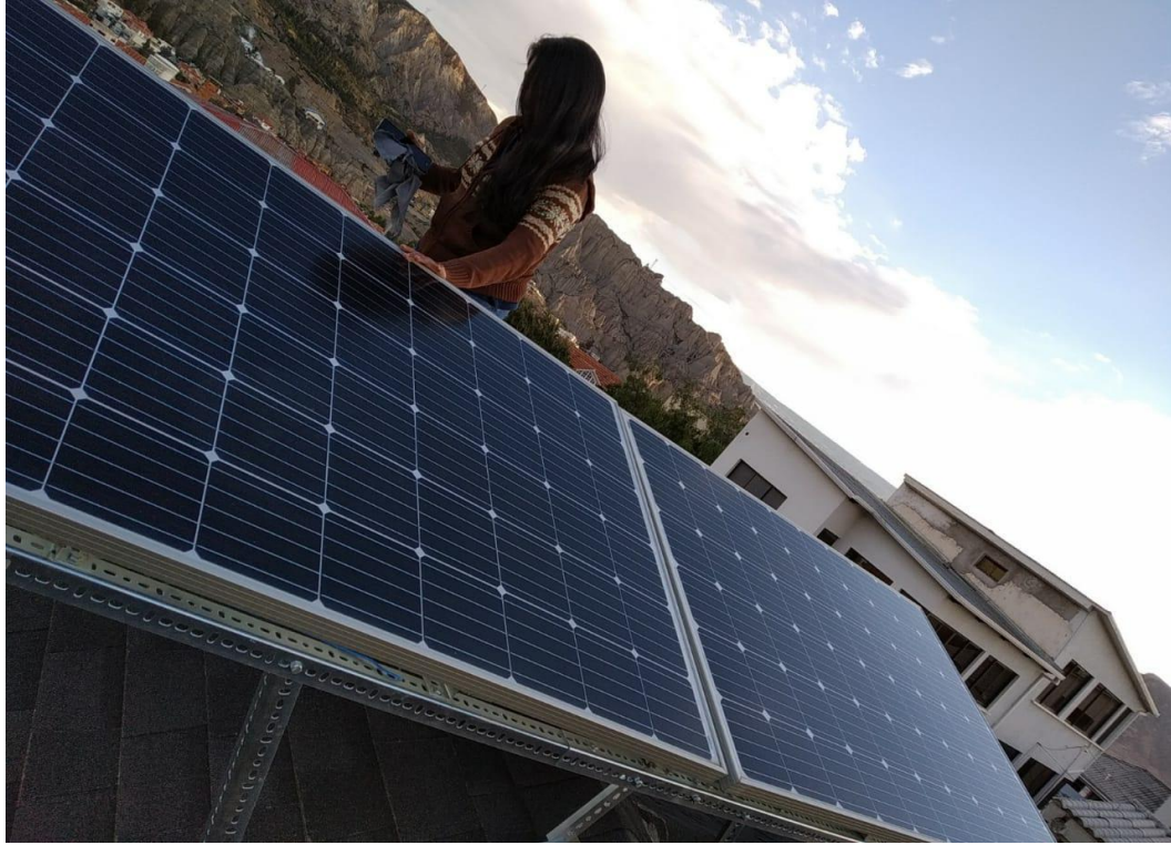
Fotografía 14 Mantenimiento del Sistema Solar Fotovoltaico.
