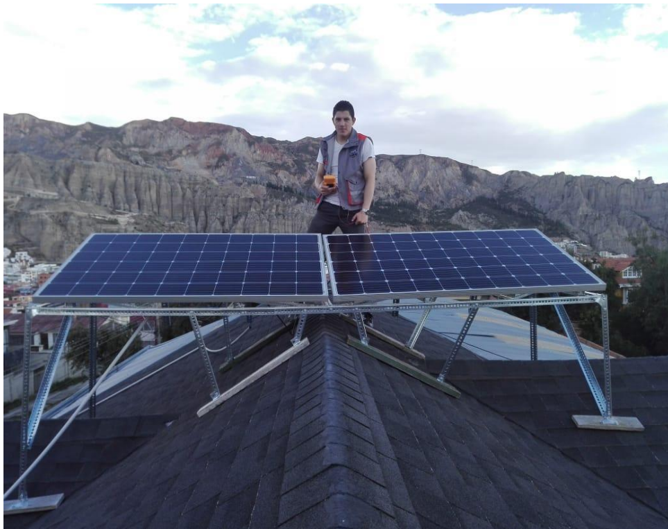
Fotografía 13 Mantenimiento del Sistema Solar Fotovoltaico.
