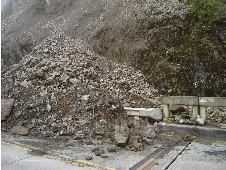
Fotografía N° 4. Vista general de un deslizamiento menor activo en la progresiva 3+863.
