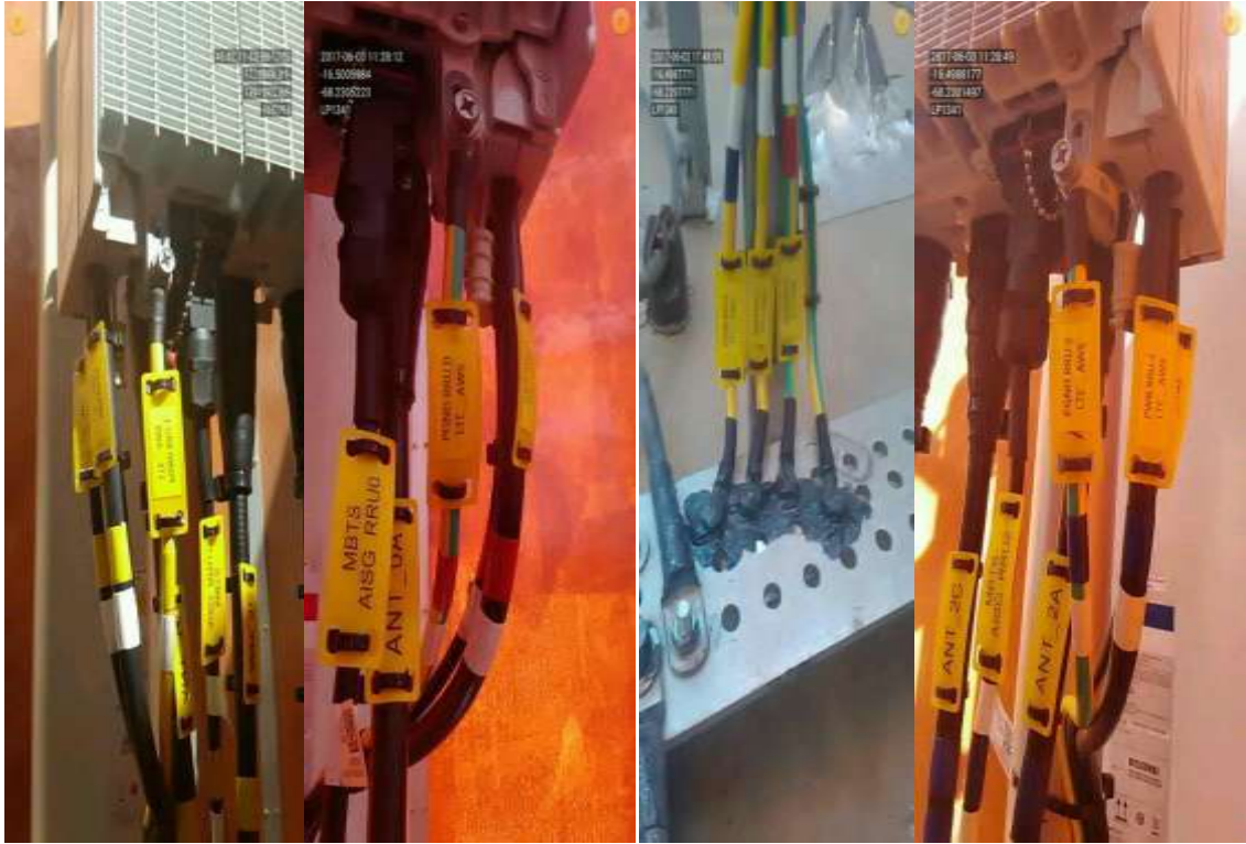
Figura 95 Aterramiento de las RRUS
