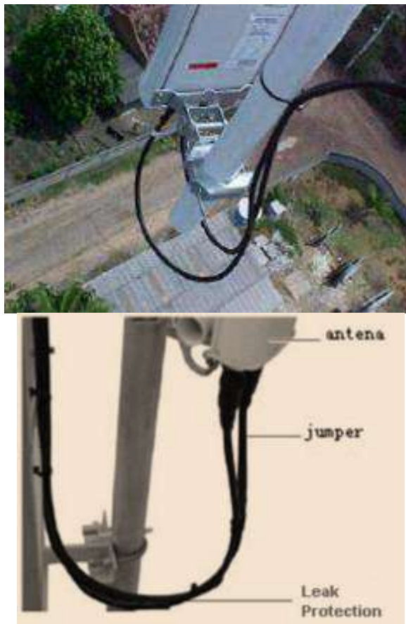
Figura 86 Vulcanizada protección contra goteo
