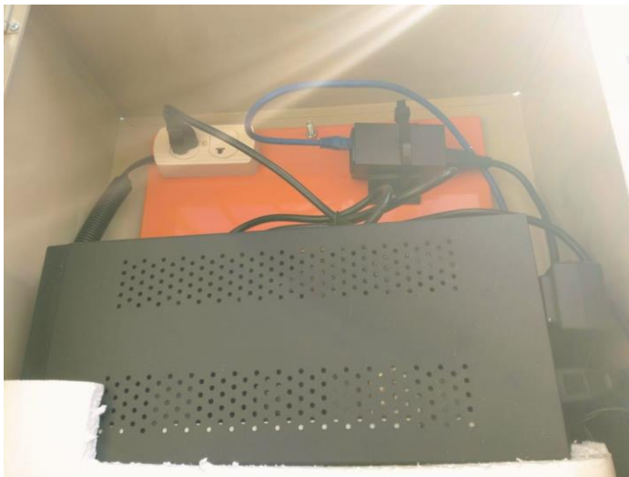
Figura 5.40 Gabinete outdoor para UPS
