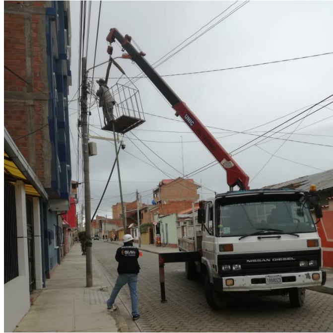
Figura 5.39 Montaje de punto con antena y PTZ
