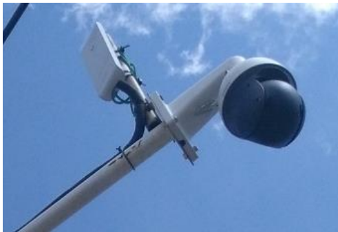
Figura 5.4 Antena y cámara instalada
