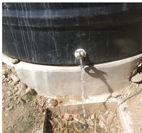
PILETA DE DISTRIBUCIÓN
