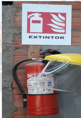
Ilustración 23: Ubicación de extintor
