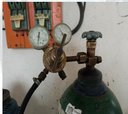
Fotografía 9. Cilindro de oxígeno industrial y manómetro Fuente: Elaboración propia
