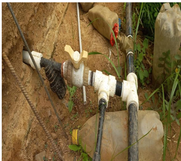
Accesorios principales para el correcto funcionamiento del método de riego por goteo.
