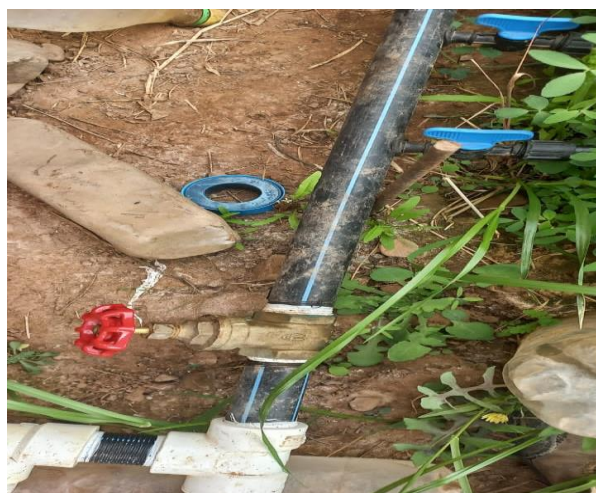
Accesorios de para una línea de distribución.
