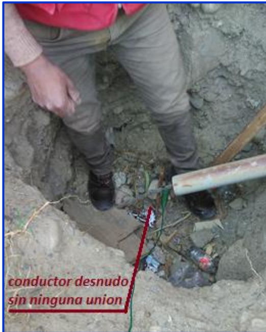
Figura 12. Conductor desnudo sin unión
