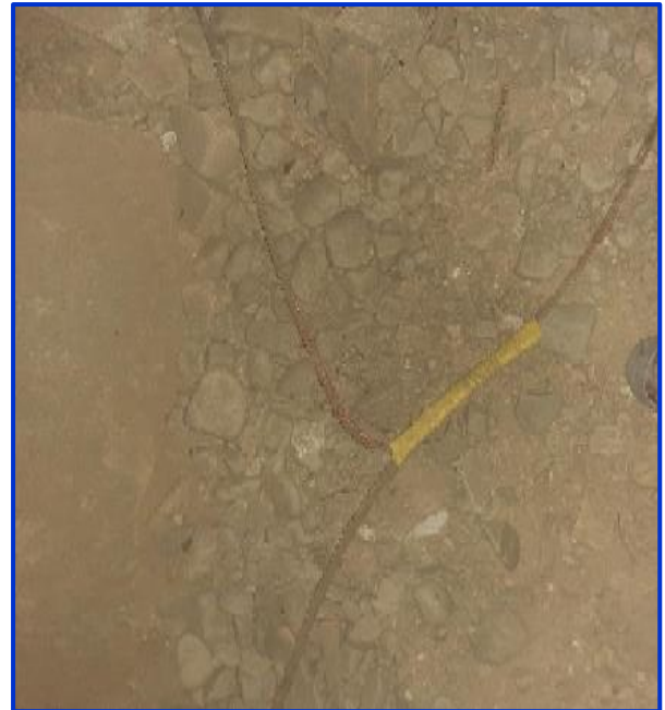
Figura 13. Conductor de tierra con unión no adecuado
