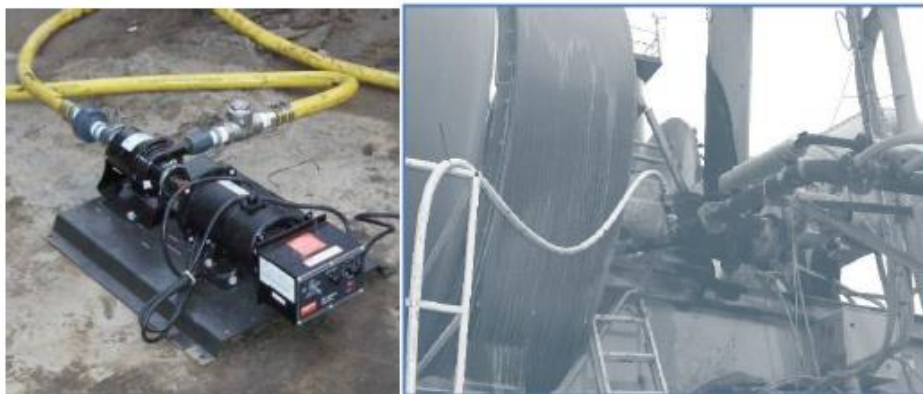
Figura N° 14. Bomba volumétrica y punto de inyección de Evotherm
