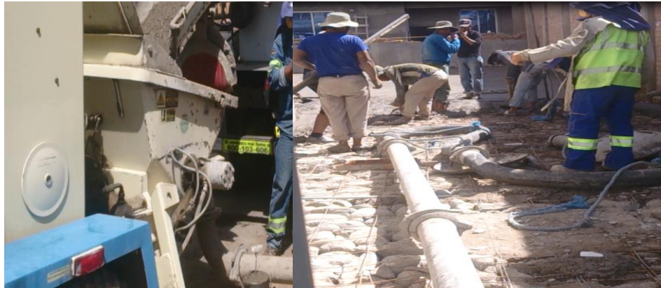
FIGURA 3-6 BOMBA Y TUBERÍA PARA BOMBEO
