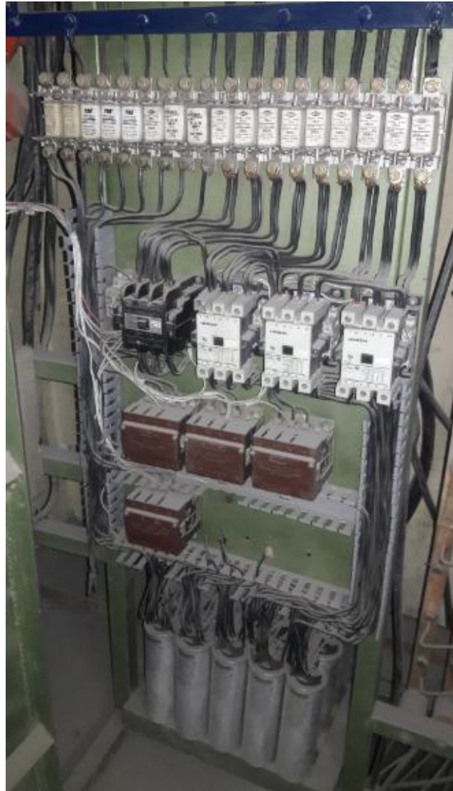
Figura 3.3 Banco de capacitores instalado con anterioridad
