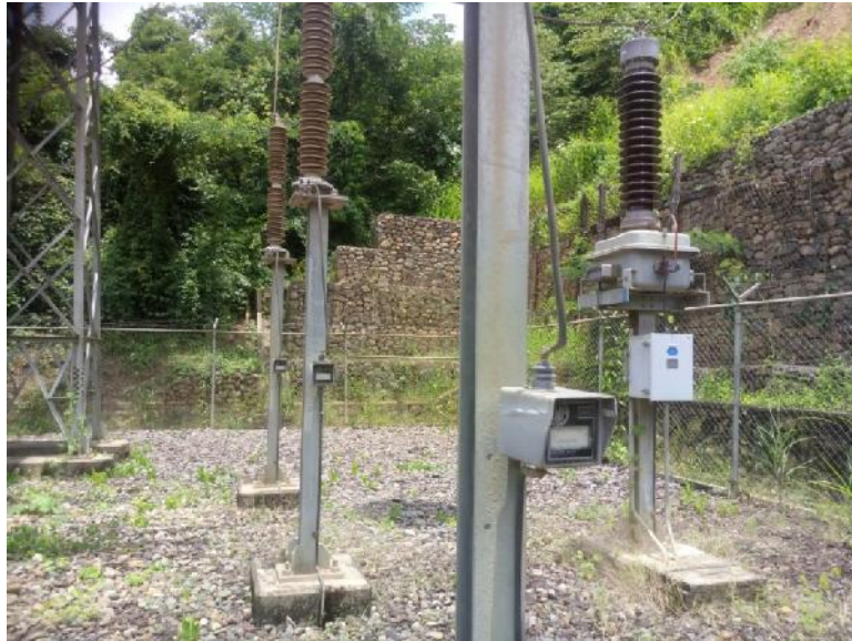
Fotografía Muestra los contadores de descargas eléctricas
