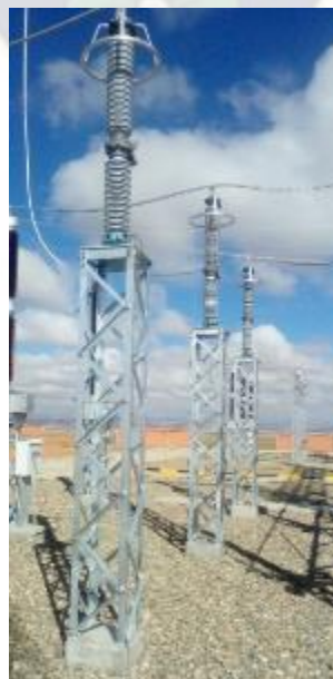
Figura 43 - Vista pararrayos de óxido de zinc
