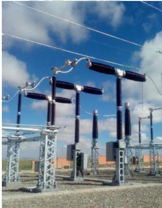
Figura 36 - Vista de Interruptor 3AP2 FI
