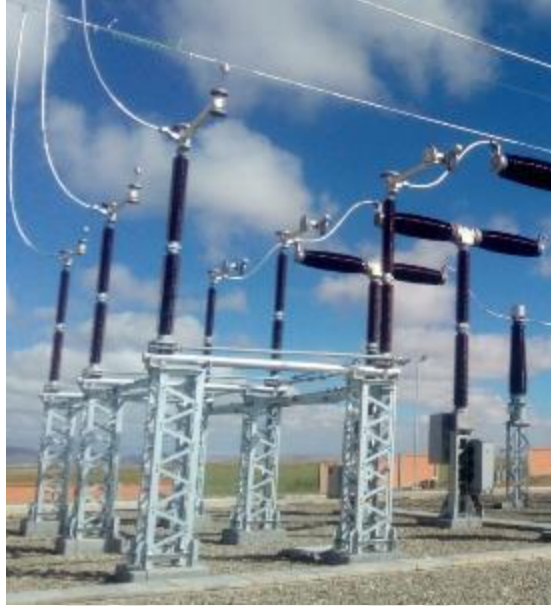
Figura 37 - Vista seccionador SIEMENS
