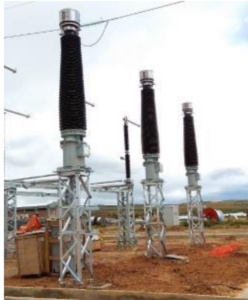
Figura 39 - Vista transformador de corriente ABB
