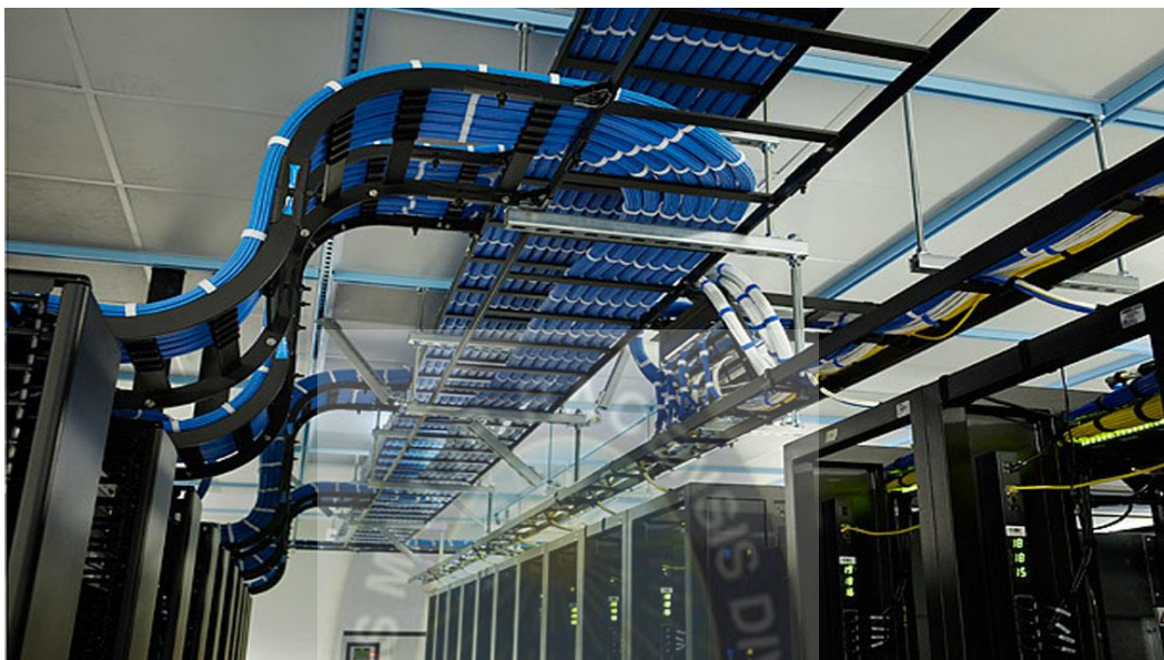
Figura 2.3. Infraestructura de Centro de datos.
