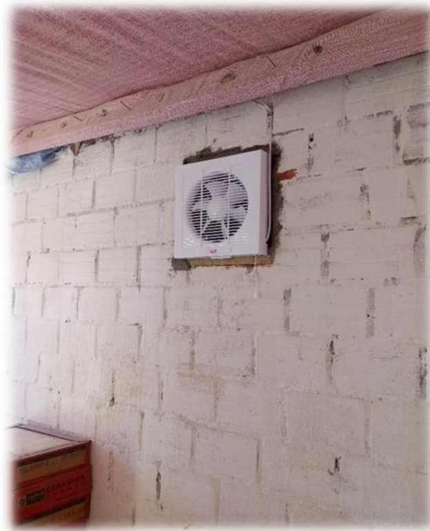
Figura 4. Implementación de extractor/ventilador en área de recepción e inicio. (Elaboración propia).
