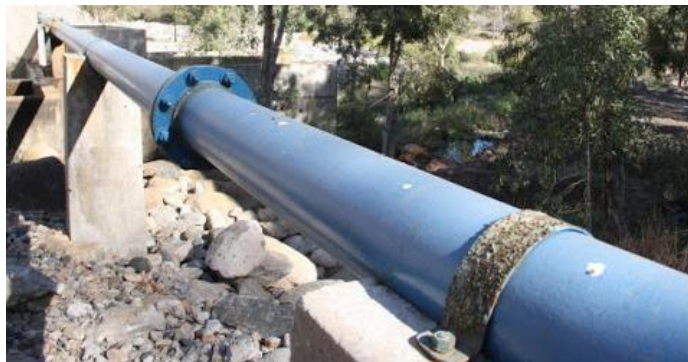
Ilustración 3 Toma de Agua de Río
