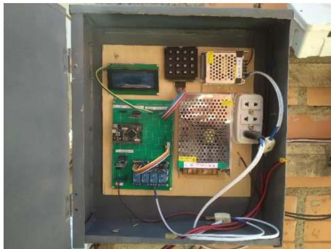
Figura 13 Tablero de control
