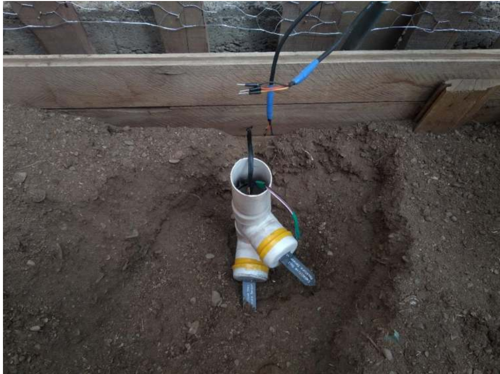
Figura 19. Instalación de los sensores
