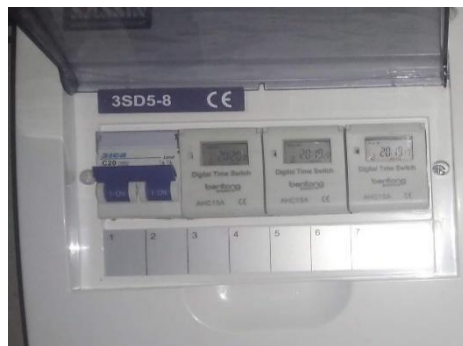
Figura 10. Instalación eléctrica de los timers.
