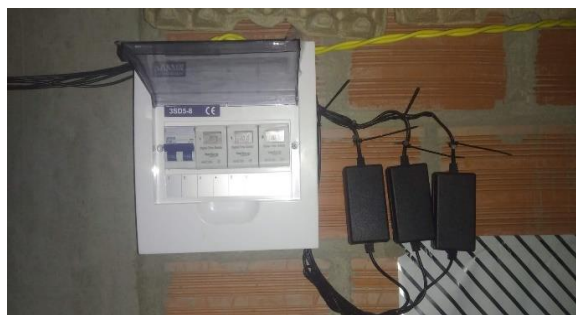
Figura 11 Instalación completa del sistema de iluminación, caja térmica, transformadores, timers y un térmico.
