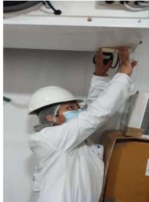
PRUEBA DE ENCENDIDO Y APAGADO
