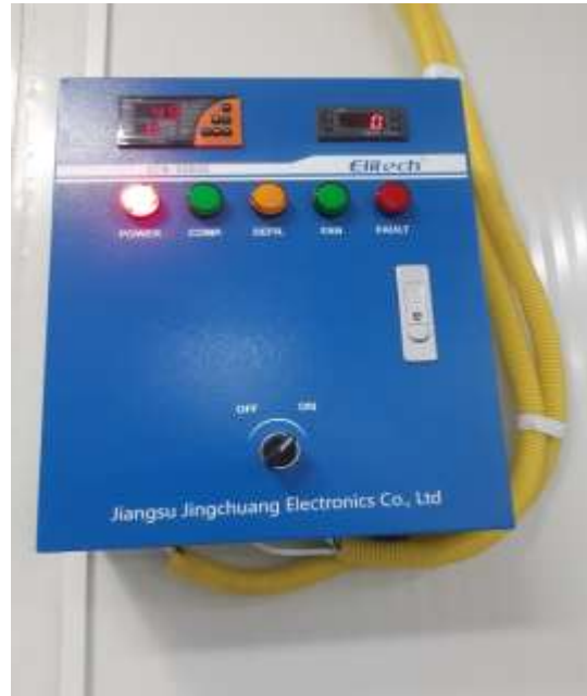
PANEL DE CONTROL DE TEMPERATURA CÁMARA 2
