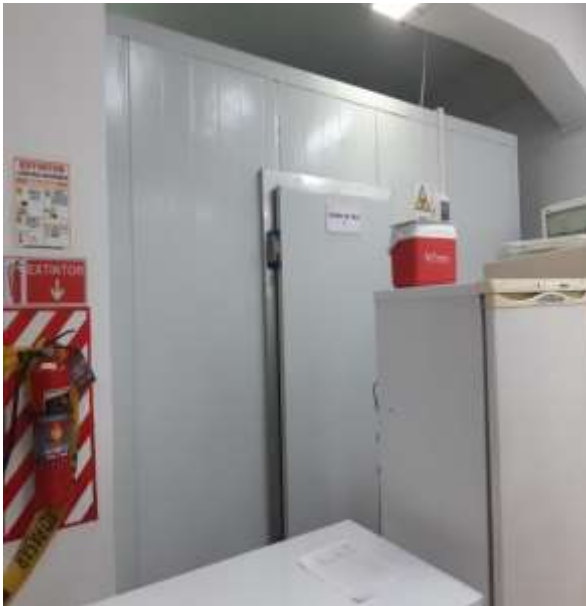
CÁMARA DE FRÍO 1
