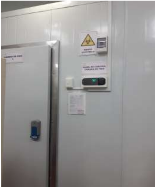
PANEL DE CONTROL DE TEMPERATURA CÁMARA 1
