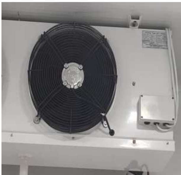
VENTILADORES DENTRO DE CÁMARA DE FRÍO
