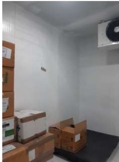
PRUEBA DE MAPEO TÉRMICO SIN CARGA
