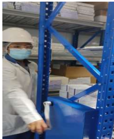
ESTANTERIA DENTRO DE CÁMARA DE FRÍO
