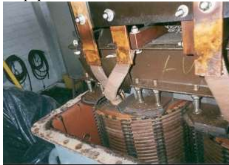
Figura 25 Bobinas y Chicotes de un Transformador Recubiertos de Papel
