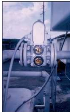
Figura 34 Relé Buchholz Instalado en un Transformador de 20 MVA
