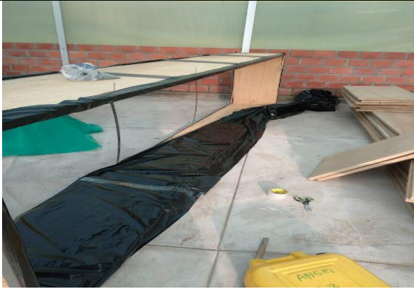
El proceso de forrado con nylon negro de las paredes de cada platabanda
