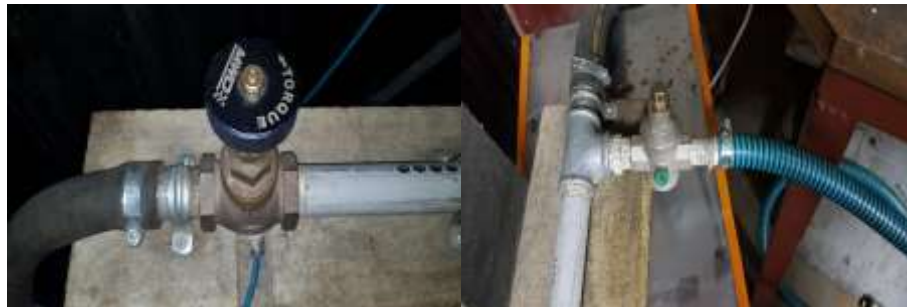
Figura 37 Válvulas de control de torque.
