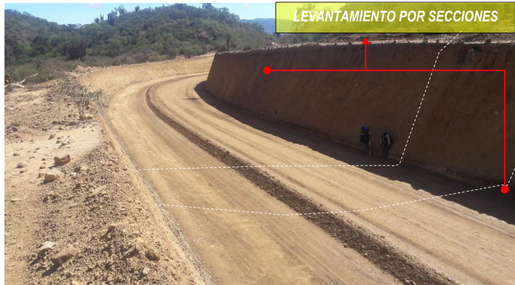
Figura No. 50 - Seguimiento de la ejecución de los trabajos de construcción Fuente. Elaboración propia
