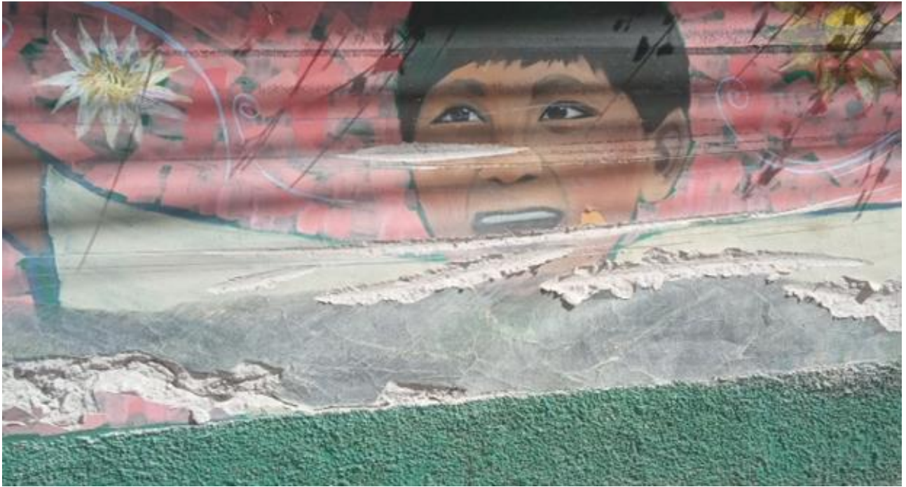
Figura 82 Fotografía del daño del “muro #7” a causa de un accidente automovilístico.
