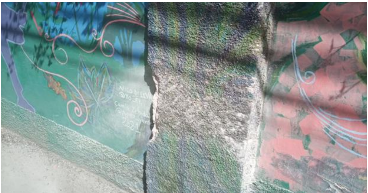
Figura 83 Fotografía del daño de una columna a causa de un accidente automovilístico.
