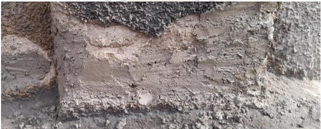
Figura 38 Fotografía del proceso de restauración con cemento en la parte inferior de una columna
