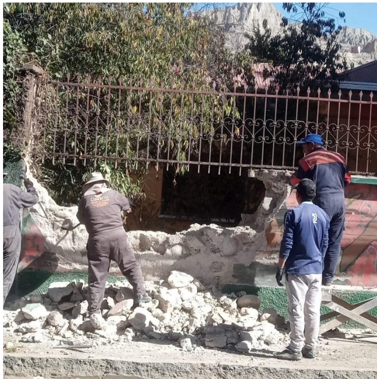
Figura 85 Fotografía a detalle de la demolición del “muro #7”, a causa de un accidente automovilístico, por riesgo de derrumbe.
