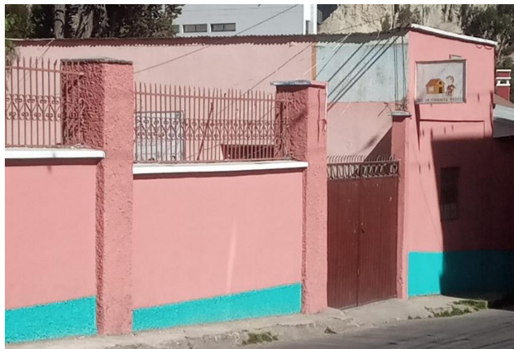
Figura 87 Fotografía #2 del pintado por parte de los albañiles del SEDEGES de los muros externos del Centro de Acogida Niño Jesús sobre la calle 3 de Obrajes.
