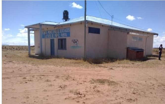
Anexo 4. Paredes con superficie impermeable.
