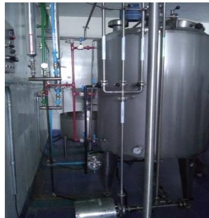
Tanque de pasteurización de leche y yogur
