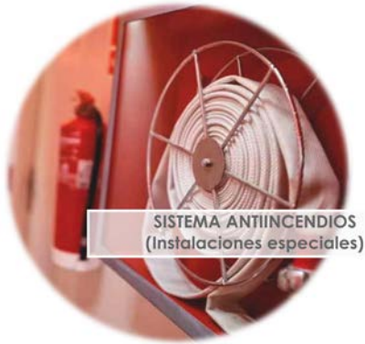
Imagen 29. Sistema de protección contra incendios
