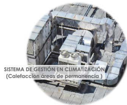
Imagen 30. Sistema de climatización roof-top
