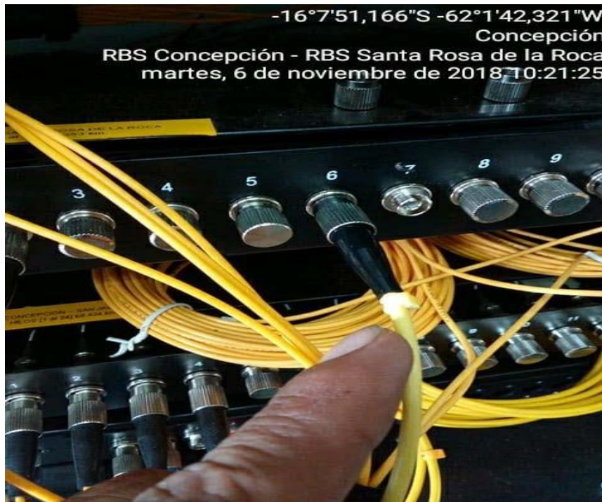
Figura 34. Movimiento de conectores en ODF
