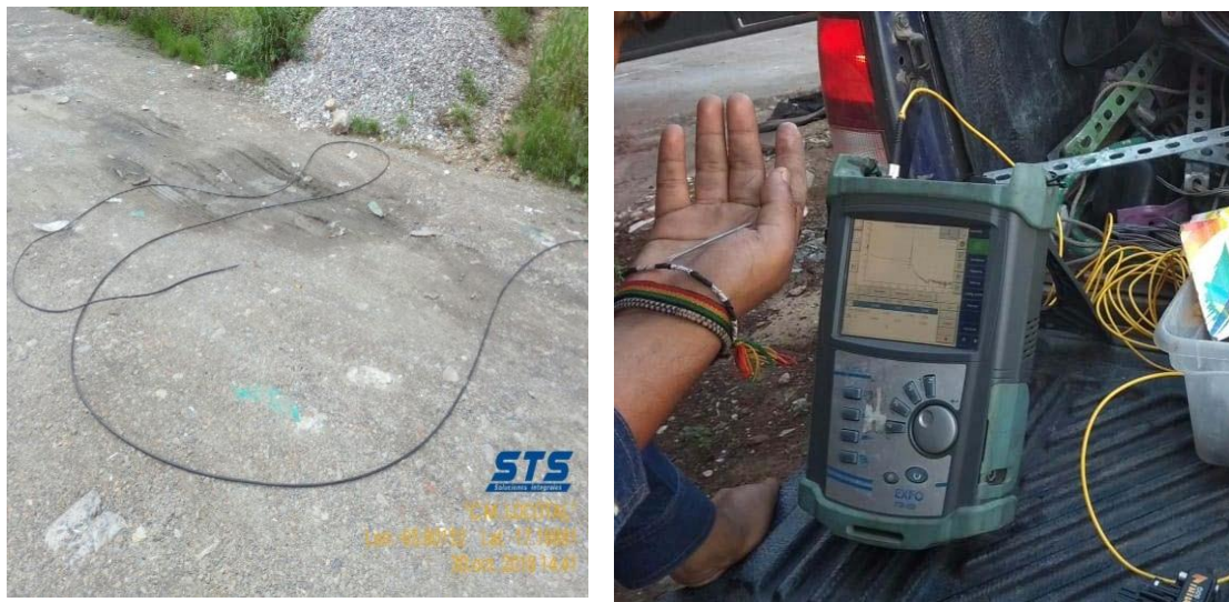
Figura 25. Cable de fibra óptica dañado botado en piso. Equipo OTRD certifica los puntos afectado por el accidente
