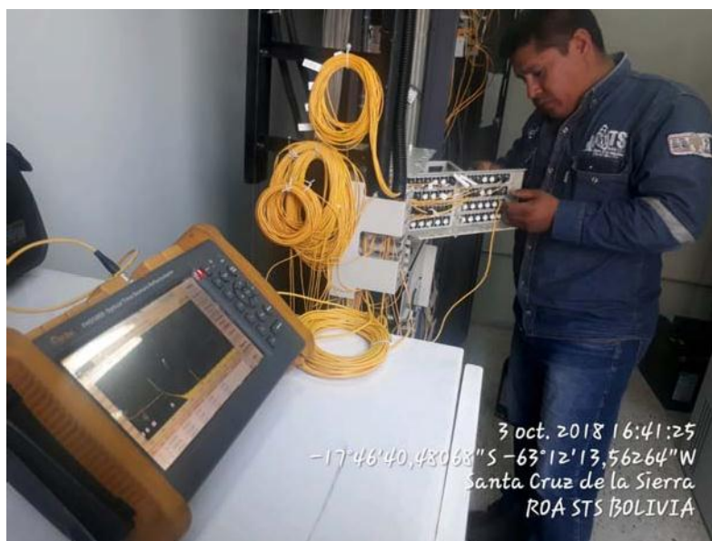
Figura 28 Personal realiza conexión de pach cord en ODF
