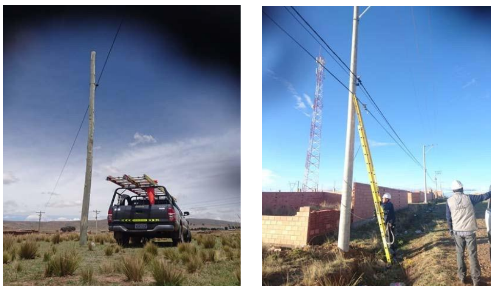
Figura 18. Instalación de ferretería en poste de energía y asegurado de Cable de fibra óptica
