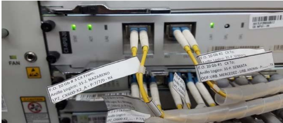
Figura 21. Conexión de pach cord en el equipo de fibra óptica
