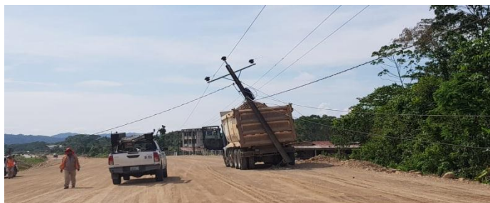
Figura 16. Poste de energía junto a la instalación de cable de fibra óptica
