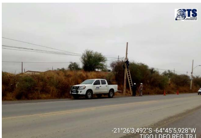
Figura 30. Personal realiza mantenimiento en la red de Fibra Óptica con previa precaución
