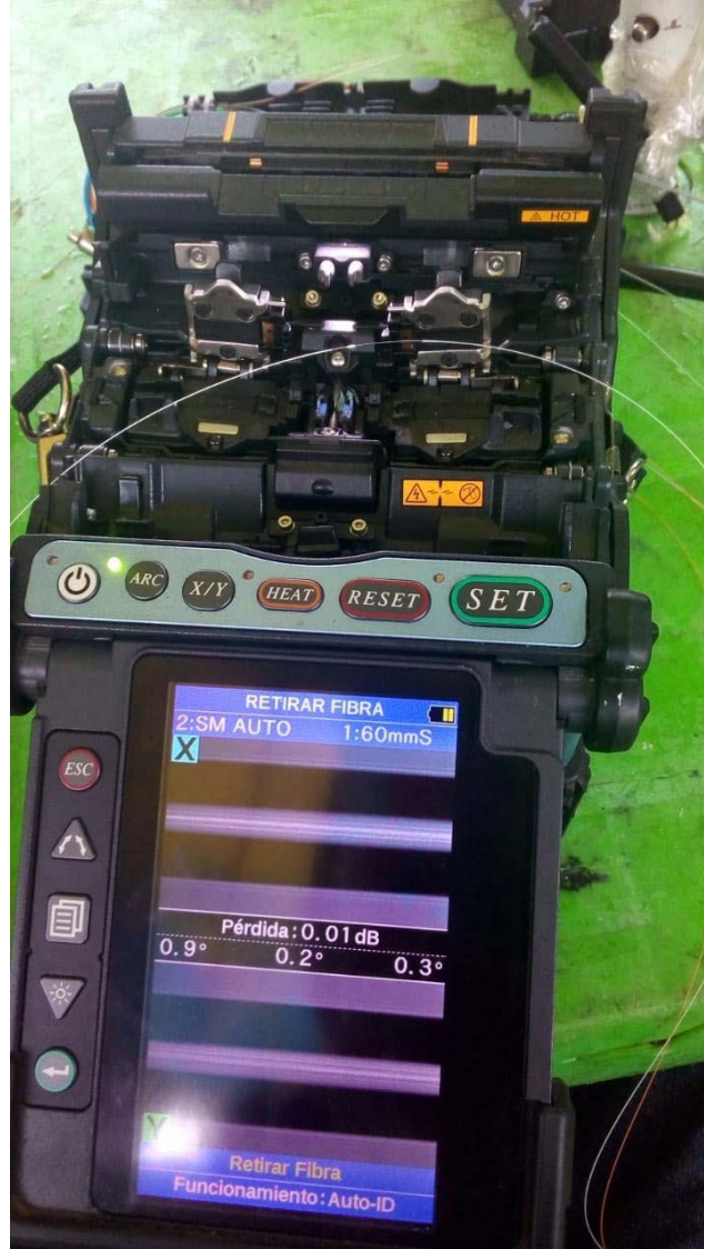
Figura 63. Equipo Fusionadora con pérdida de 0.01 dB
