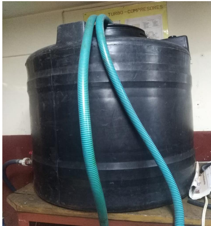
Figura 24. Depósito de agua
