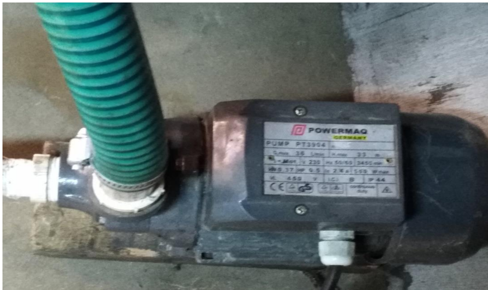
Figura 23. Bomba de agua
