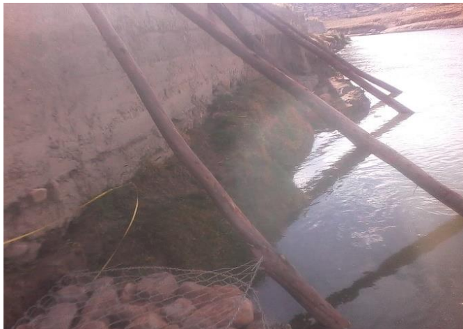
Fotografía 1: Deterioro del Hormigón ciclópeo
