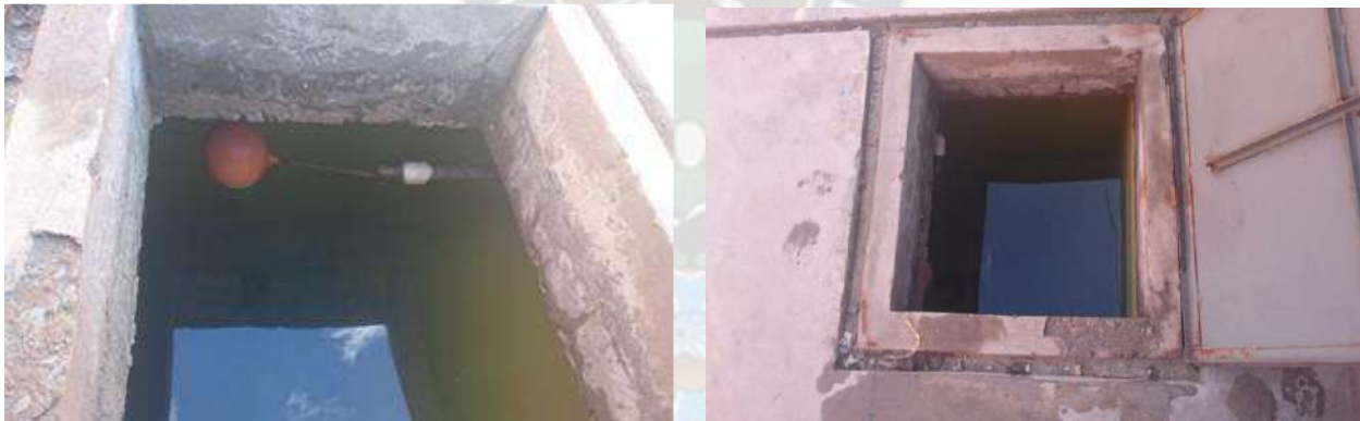
Figura 17 Vista general de la cámara de acopio de agua potable, para el proceso de teñido.
