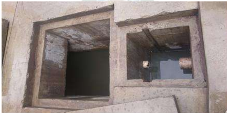
Figura 24 Cámaras de salida y acopio de los residuos del teñido
