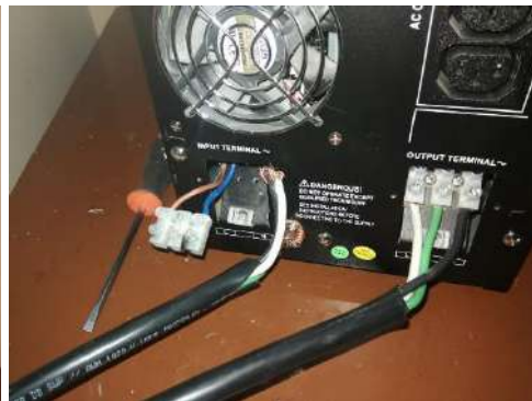
Figura 2.- Puertos de conexión eléctrica.
