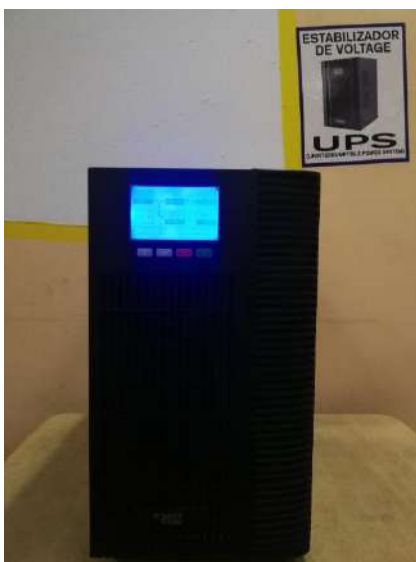
Figura 10.- Estabilizador de voltaje UPS
