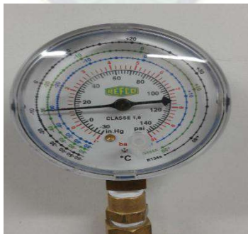
Figura 3.26 Lectura de presión y temperatura de evaporación (Fuente: Elaboración Propia)
