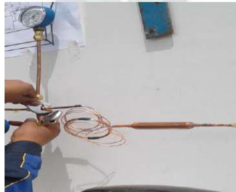
Figura 4.53 Unión roscada a la salida del capilar (Fuente: Elaboración Propia)
