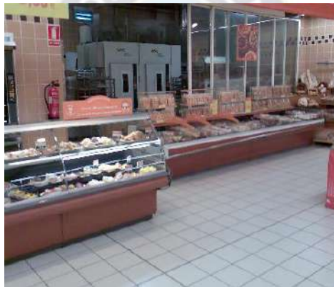
Figura 2.6 Refrigeración Comercial (Fuente: http:// www. Sistemasrefrigeración.com )
