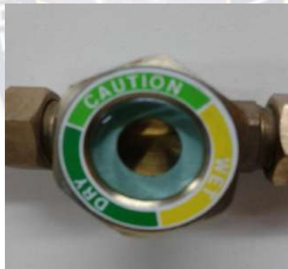
Figura 4.65 Visor de líquido con refrigerante licuado (Fuente: Elaboración Propia)
