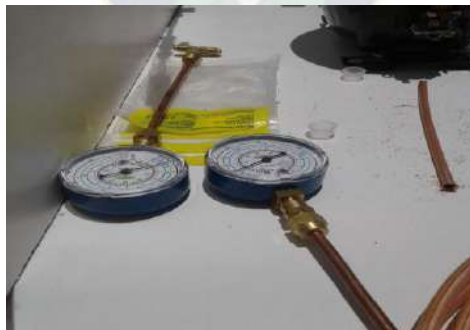
Figura 4.50 Manómetros de baja presión (Fuente: Elaboración Propia)
