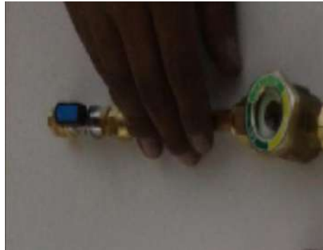
Figura 4.43 Instalación de la válvula de manual a la salida del visor (Fuente: Elaboración Propia)
