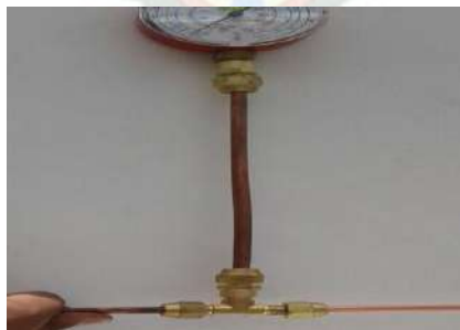
Figura 4.35 Manometro de alta instalado (Fuente: Elaboración Propia)
