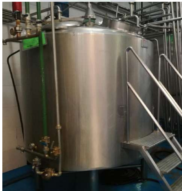
Figura 4. 1. Tanque de elaboración MIX1 (2500 L)
