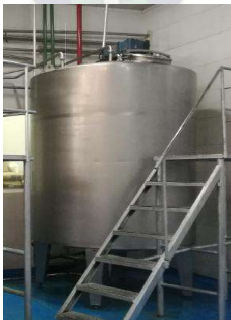
Figura 4. 3. Tanque de elaboración MIX3 (5000 L)
