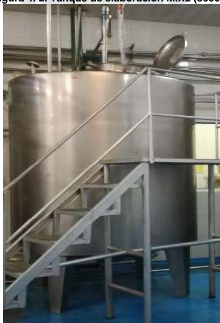
Figura 4. 2. Tanque de elaboración MIX2 (5000 L)
