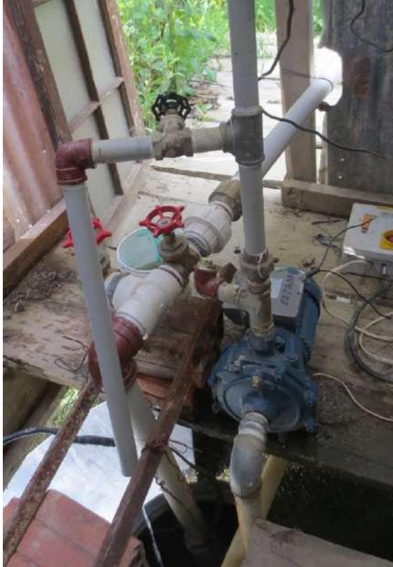
Foto 5. Agua de pozo para riego con su sistema de bombeo.
