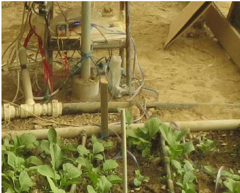
Foto 28. Sistema electrónico de riego automático.
