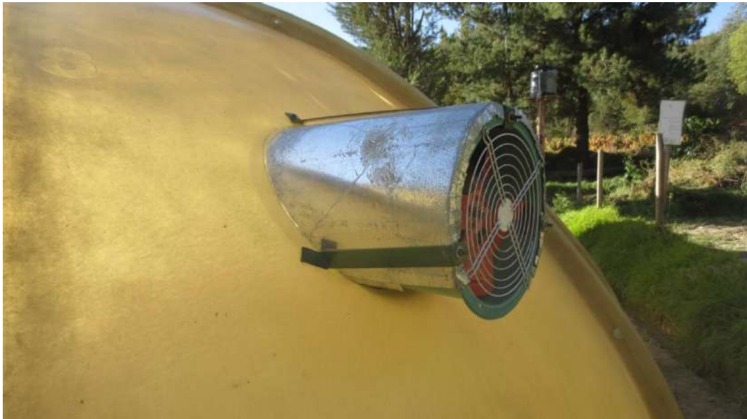
Foto 24. Vista exterior de extractor de aire.
