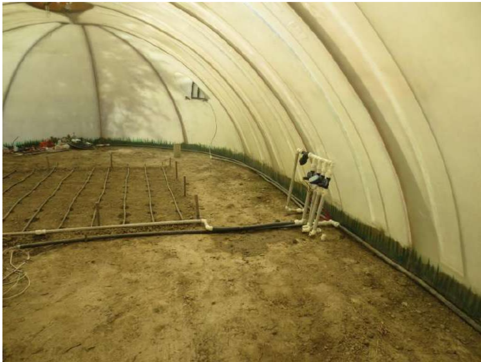
Foto 30. Sistema de riego automático instalado.
