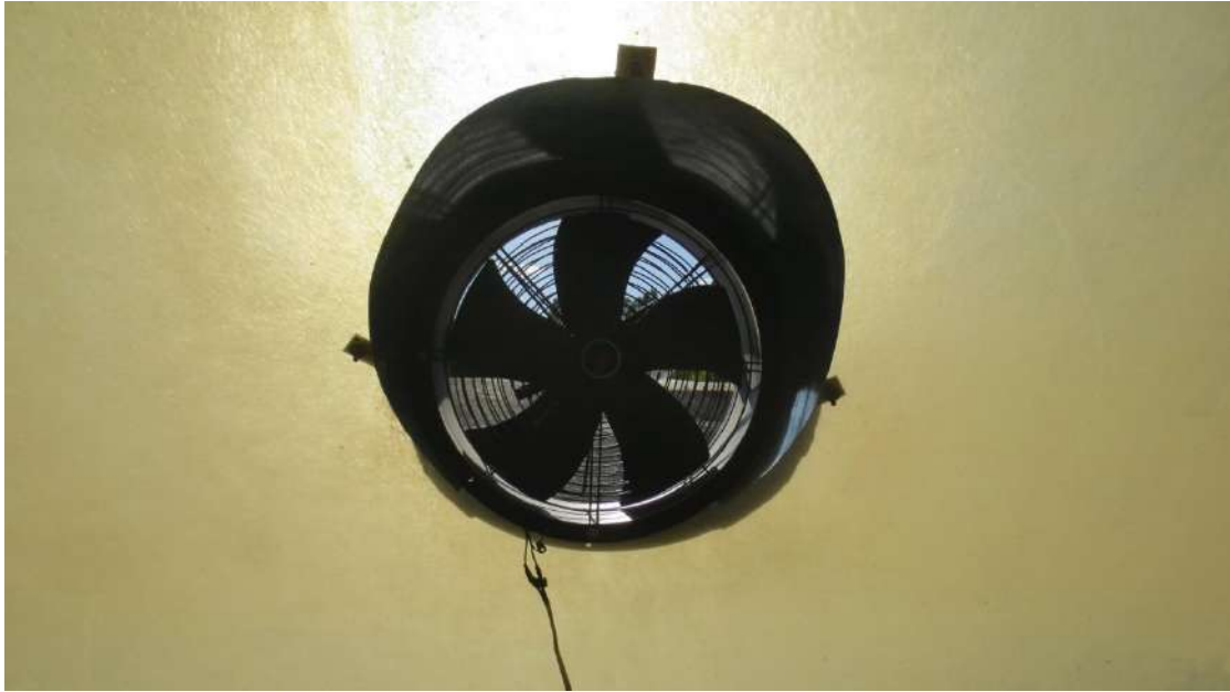
Foto 25. Ventilador vista interior invernadero móvil Pachamama.
