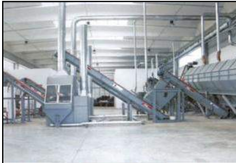
Grafico 6.9 – Sistema de aspiración instalado
