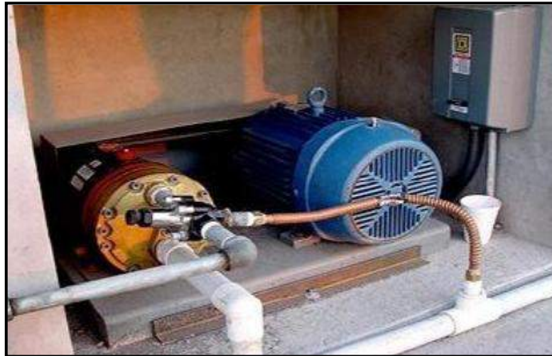
Grafico 6.3 – Bomba de Agua para lavado de NFU
