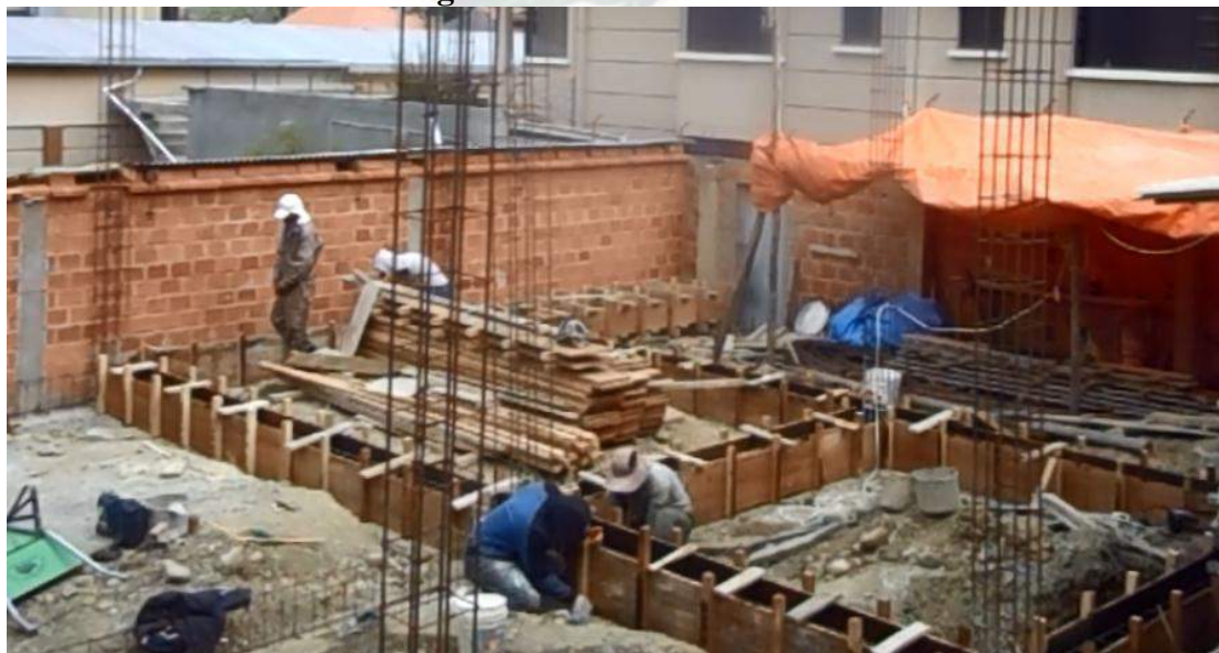
FIGURA Nro. 10 Fotografías de la conformación de la Cuadrilla para las Vigas de Fundación de H.A.
