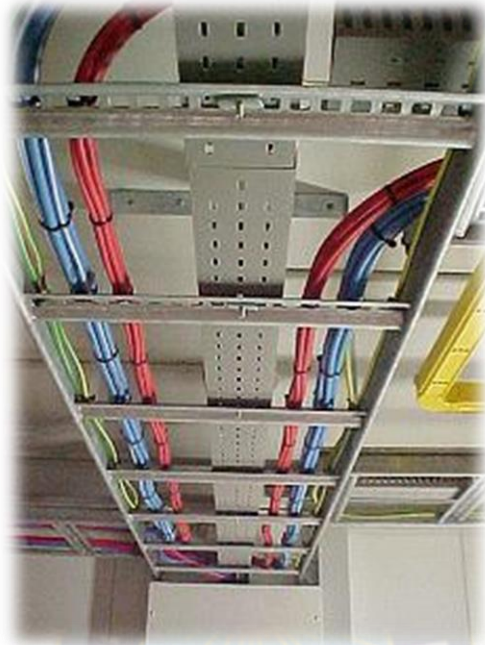
Figura 53: Distribución de red y peinado de cables
