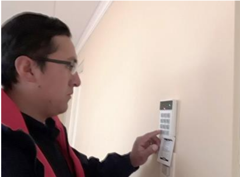
Figura 68. Realizando la programación del sistema de alarma
