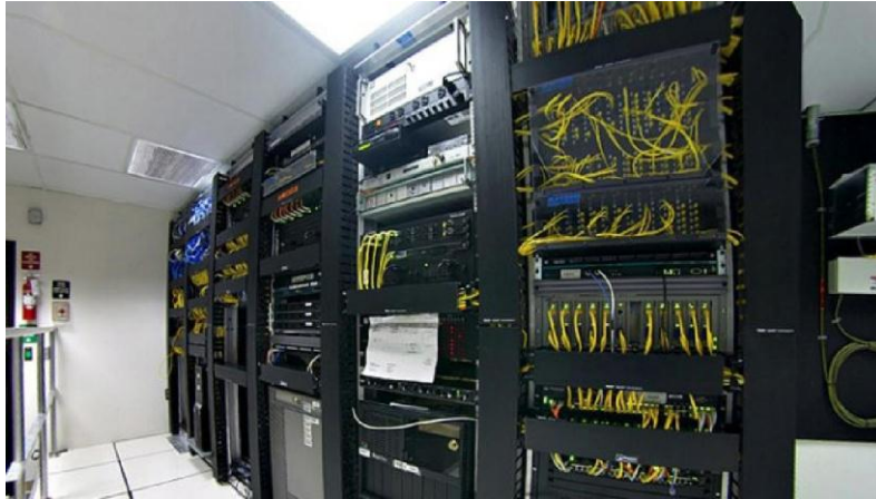
Figura 1 Data Center de la empresa Gigas.
