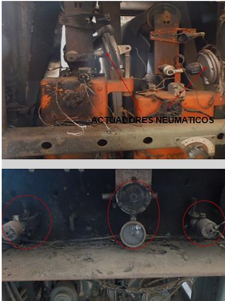
Figura 44 Fotos iniciales sistema neumático de la maquina
