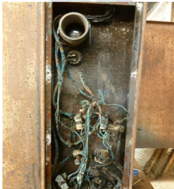
Figura 31 Tablero de control condición inicial
