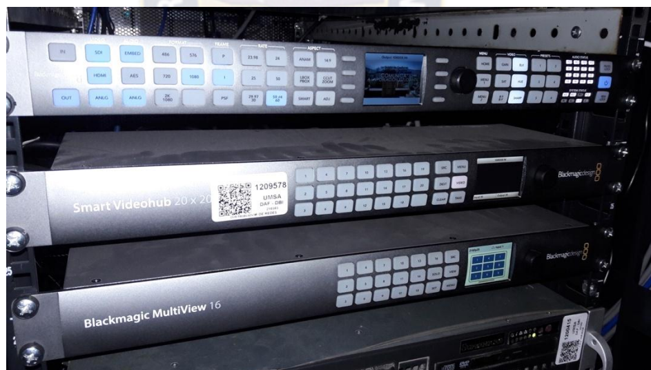
Figura 4.37 Rack equipos Blackmagic.
