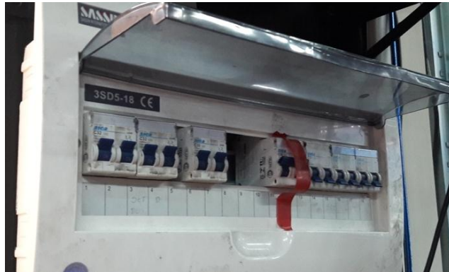
Figura 4.58 Térmicos de Luces SICA C 40 A
