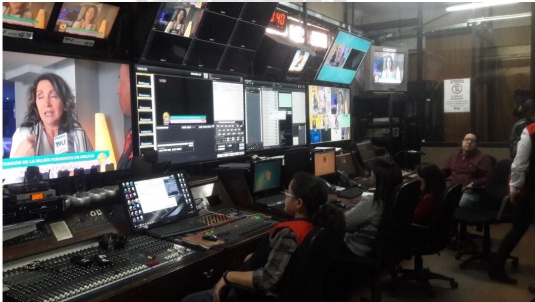
Figura 4.7 Sala de Control
