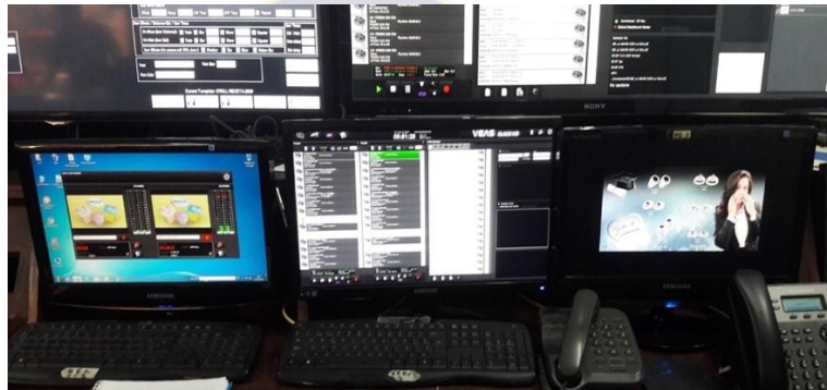
Figura 4.13 Pantallas Sala de Control
