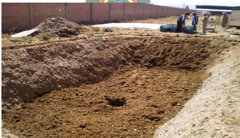
Figura 8.9. Fosa en la empresa Tusequis (Stege), para lombricultura de residuos industriales biodegradables, 74 m 3 de volumen y 120 m 2 .
