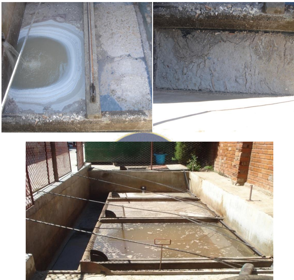
Figura 8.5. Cámara de colección de residuos disueltos y suspendidos desde la planta hasta el punto de descarga a la alcantarilla de Tusequis
