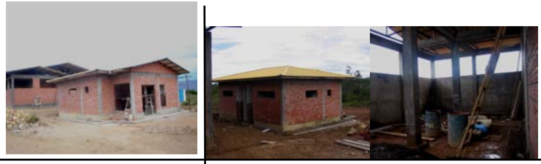
SE CULMINO CON EL TECHADO DE LOS DOS BLOQUES ADMINISTRACION Y MATADERO
