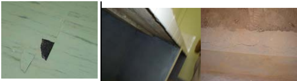
QUIROFANO PISOS VINIL, MESONES, JUNTAS DE DILATACION FALTANTES
