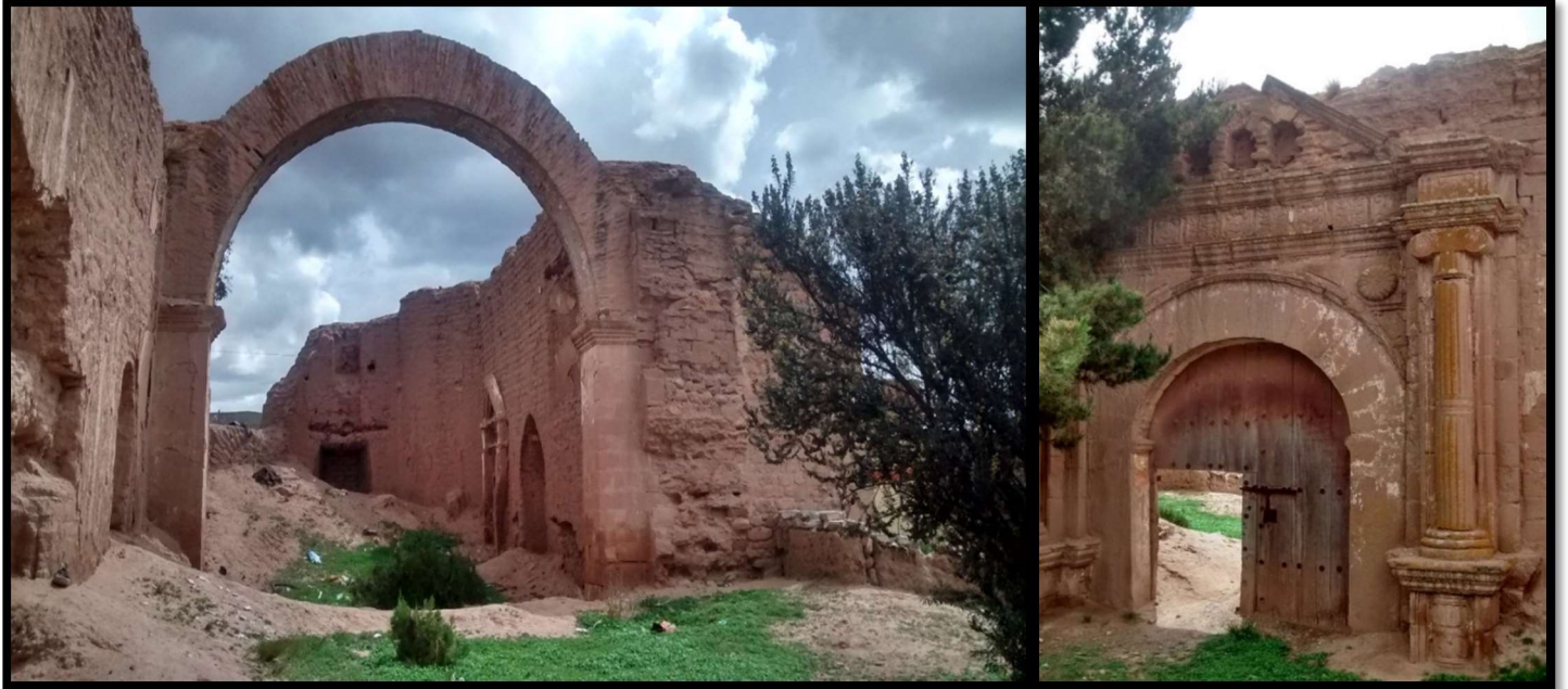
Antigua Iglesia de San Pedro de Totora colapsada
