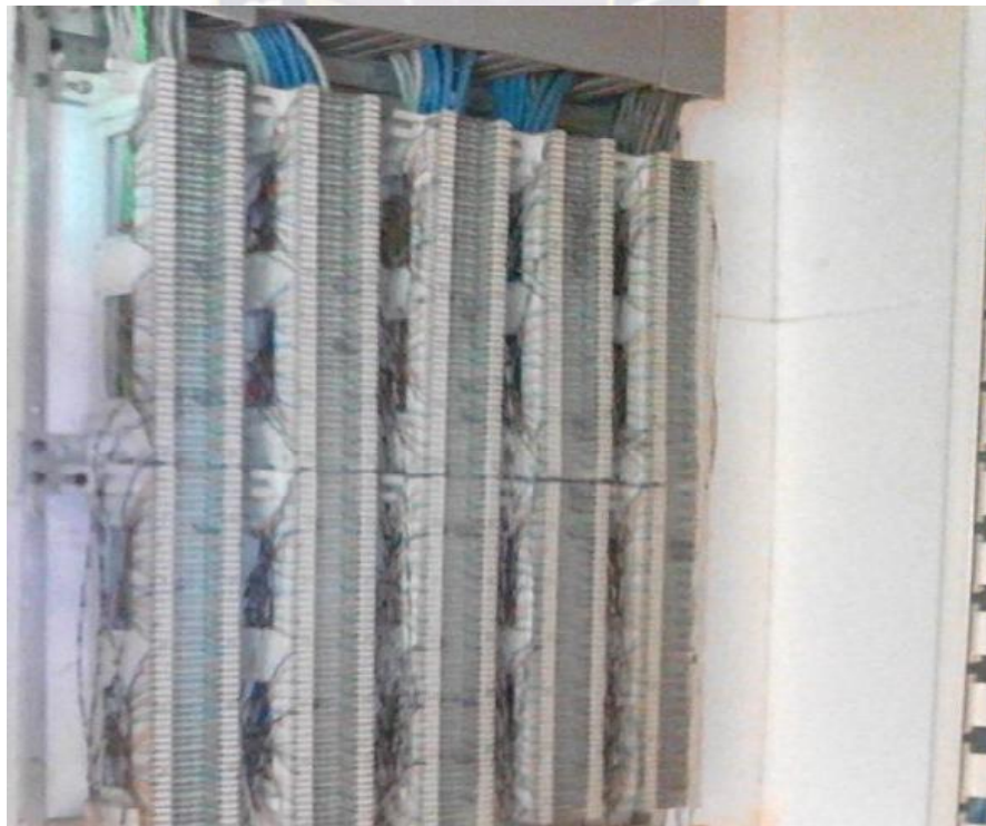
Fig. 3.5 Visita a una central telefónica, regletas de distribución de pares de abonados.
