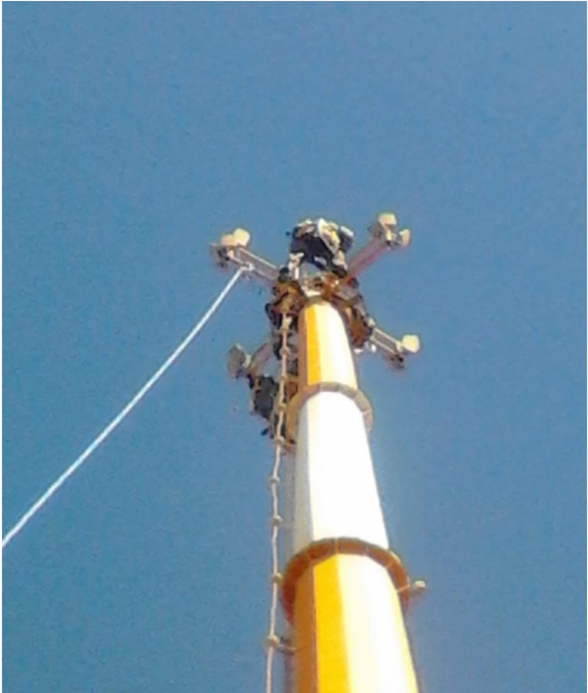
Fig. 3.7 Operaciones de Desmantelamiento de la antena de DECTLink de Gran Centro III. Fuente: Foto Propia (Pasantía)
