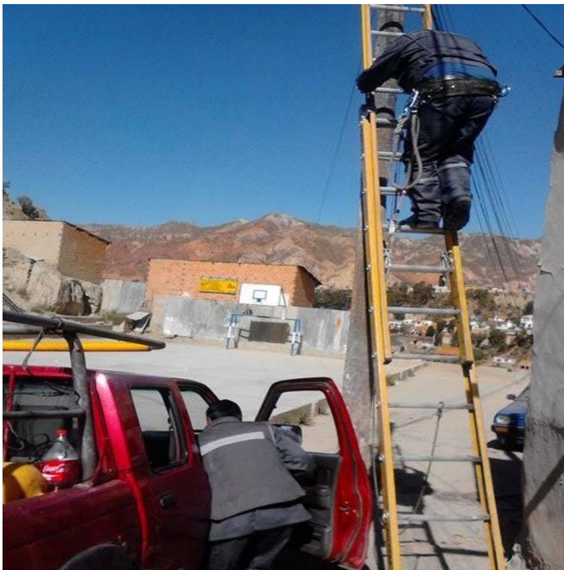
Fig. 3.3 Salida para el mantenimiento correctivo de un Nodo opto electrónico de la red HFC.
