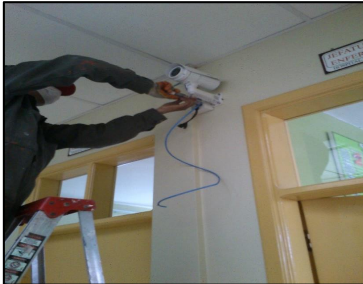
Figura 3.21 Instalación de una de las cámaras en área Administrativa
