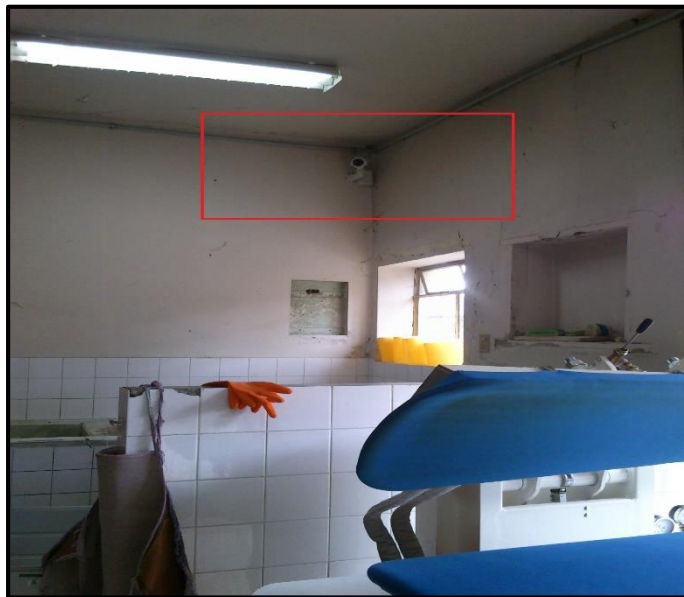
Figura 3.24 Cámara instalada en Lavandería
