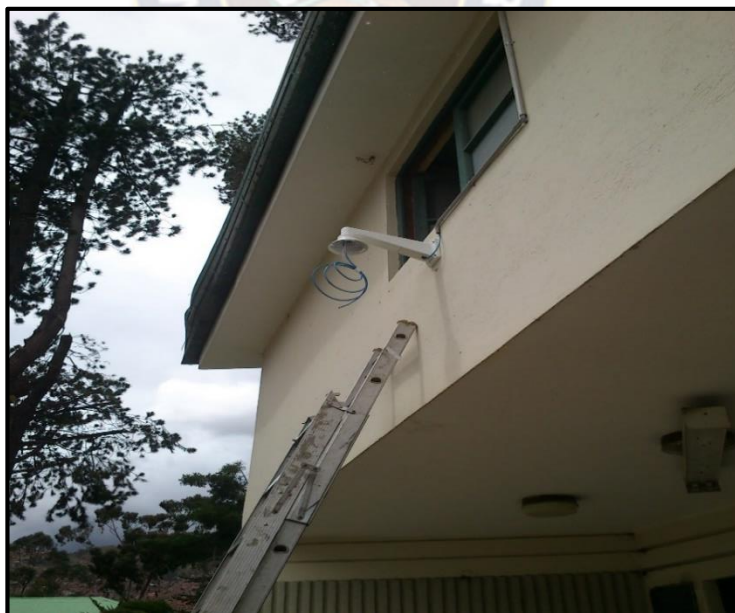
Figura 3.22 Instalación de una de cámara PTZ en área Auditórium
