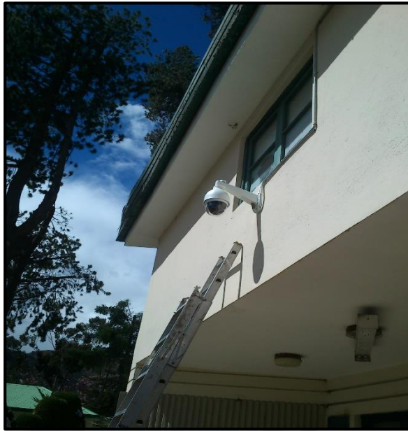
Figura 3.26 Cámara PTZ instalada en Auditorium
